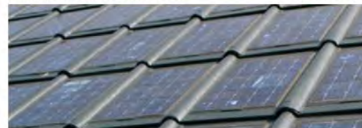
Zonnepanelen op daken
